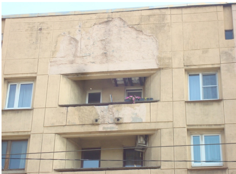
Рис. 4. Повреждение парапета в результате неправильной установки защитного фартука
