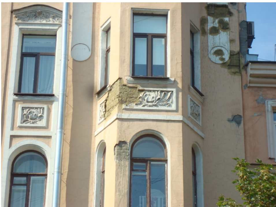
Рис. 6. Повреждение штукатурного покрытия на эркере
