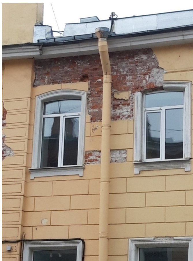
Рис. 3. Повреждение карнизного участка фасада здания со скатной крышей
