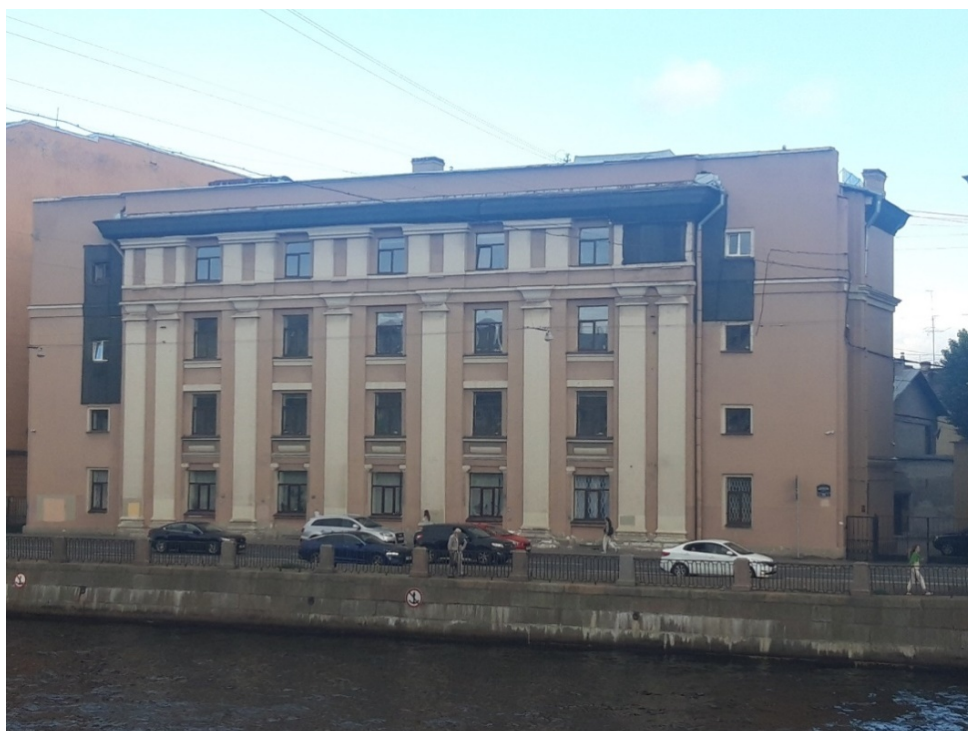
Рис. 7. Повреждение участков наружных стен, расположенных по периметру ризалита
