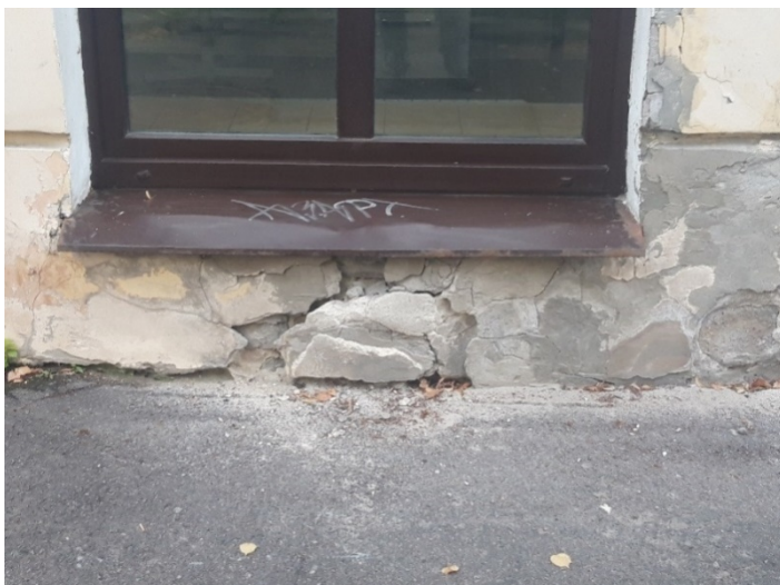
Рис. 1. Повреждение цокольного участка наружной стены
