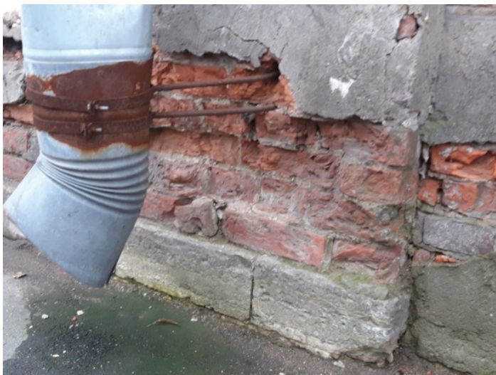
Рис. 2. Повреждение участков стен, расположенных вблизи выпусков водосточных труб
