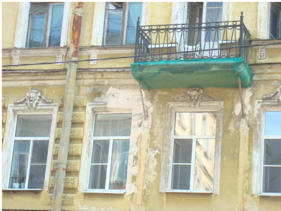
Рис. 5. Повреждение участков фасадной отделки, расположенных вблизи балконов
